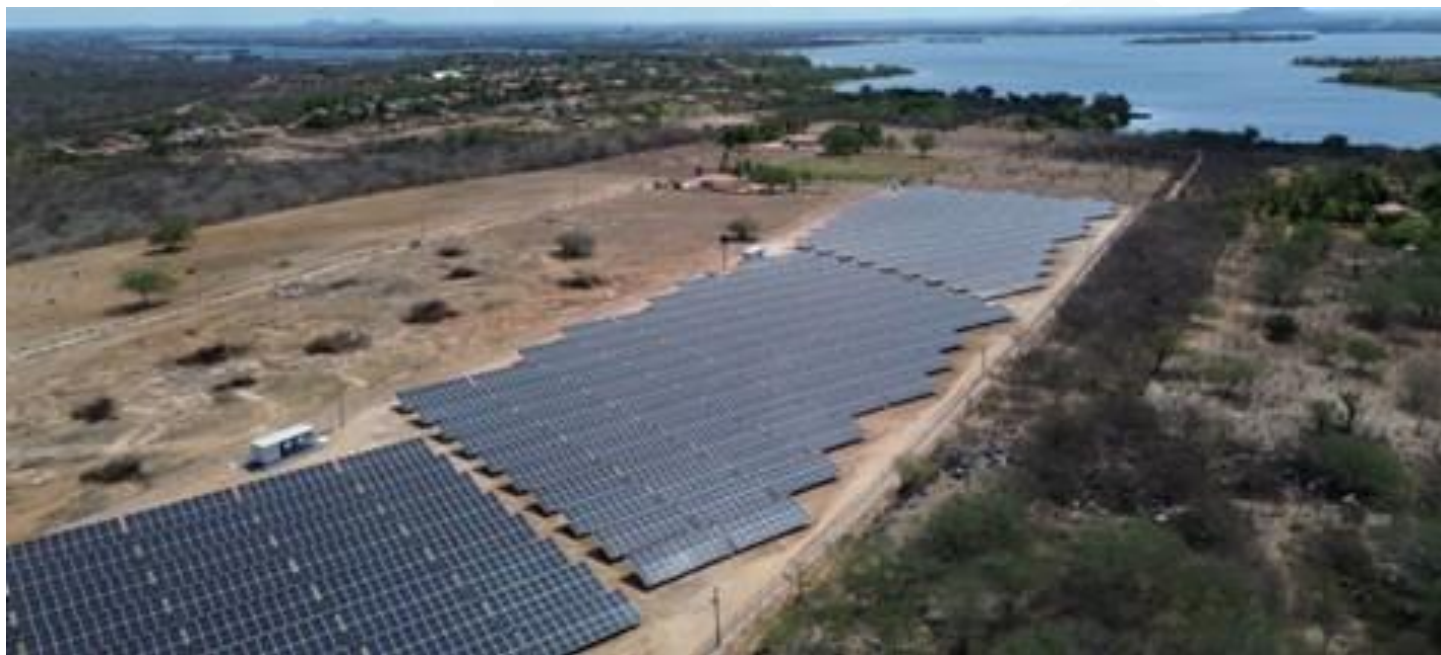
Figura 2 - Usina conta com 6 mil placas solares e capacidade para gerar até 5,7 megawatts-hora por ano. Foto: Maykon Farias - TV Tribunal.
